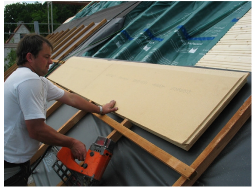
Auf den Sparren wurden zur Verminderung der Wärmebrücken Holzweichfaserplatten mit 6 cm Stärke angebracht.
