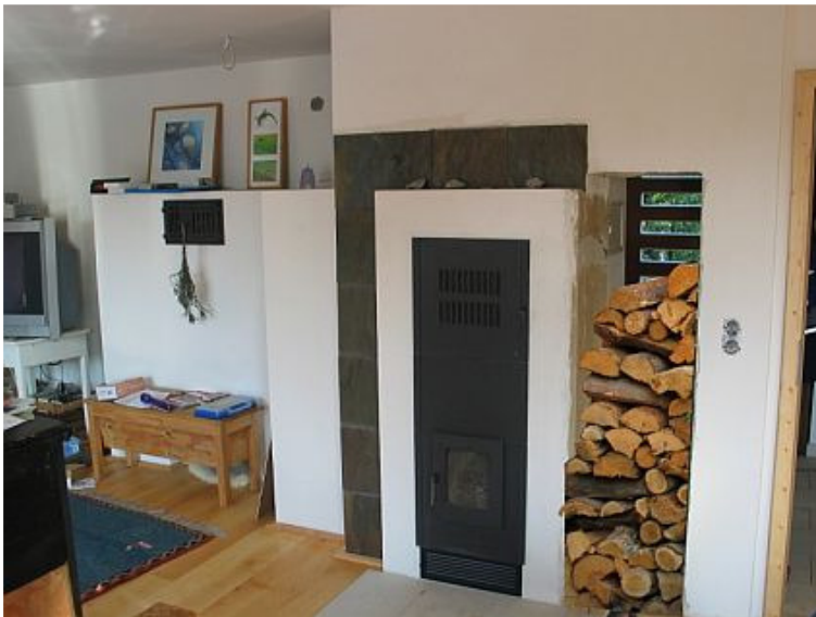
Zentrale im Erdgeschoss: Der Ofen mit angeschlossener Speicherwand. Er bildet mit einer Solaranlage und einem großen Schichtenspeicher die Zentralheizung des Hauses.
